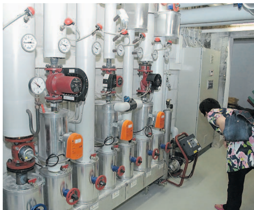
Sauber und in hervorragendem Zustand präsentieren sich die vielen Leitungen und Gerätschaften neben den Becken.
